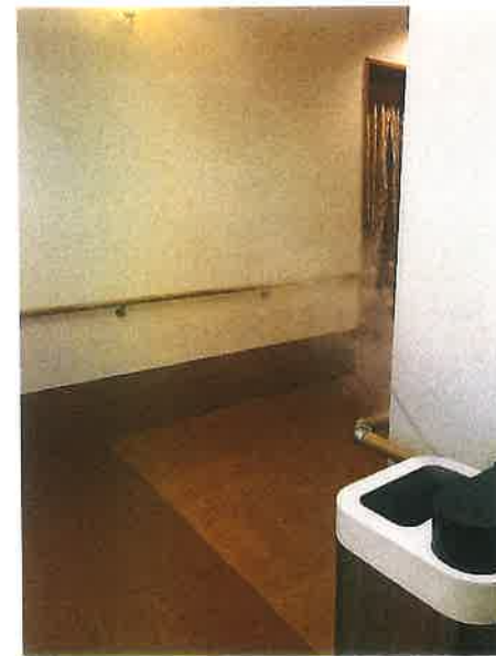
館内空間除菌装置設置
